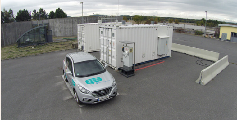
▲ Bild 3: Druckelektrolyseurmodul (hinten im Bild) und Betankungseinheit (vorn im Bild) direkt nach ihrer Aufstellung auf der Kläranlage Sonneberg-Heubisch im Herbst 2018 (Bildquelle: Andre Funke, Wasserwerke Sonneberg)
